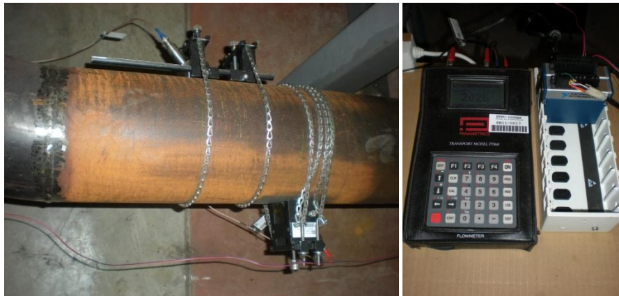
Figur 24 Oppsett av volumstrømmålar og dataloggar på R134a-varmepumpa
