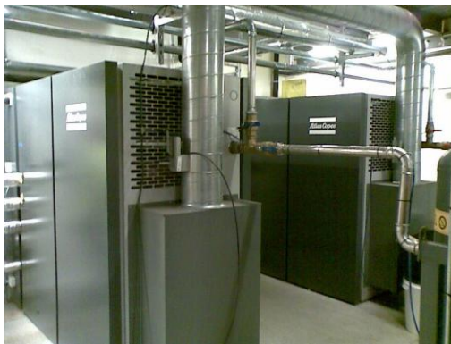
Figur 6 Trykkluftkompressorane i kjellaren i hall 16
