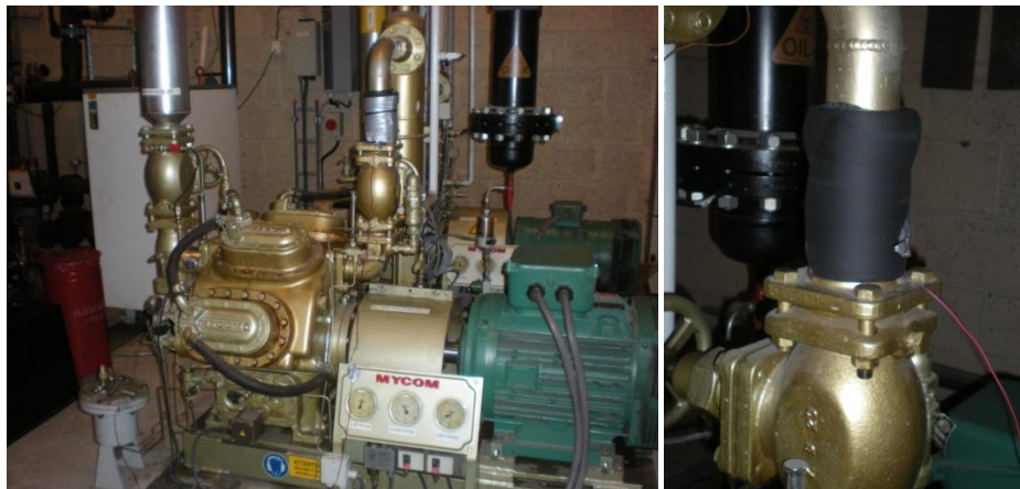
Figur 40 Måling av trykkørstyrtemperatur på kompressor 1
