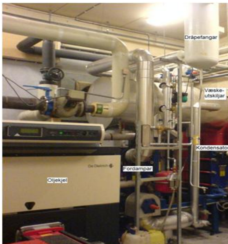
Figur 11 R717-varmepumpa i teknisk varmesentral [Kalve, 2008]
