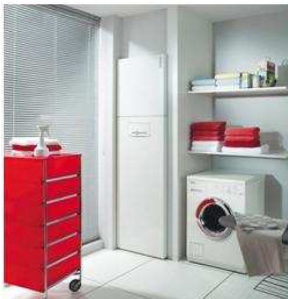
Figur 5.1 Kompaktaggregat fra Viessmann plassert på bad (Viessmann, 2007).
