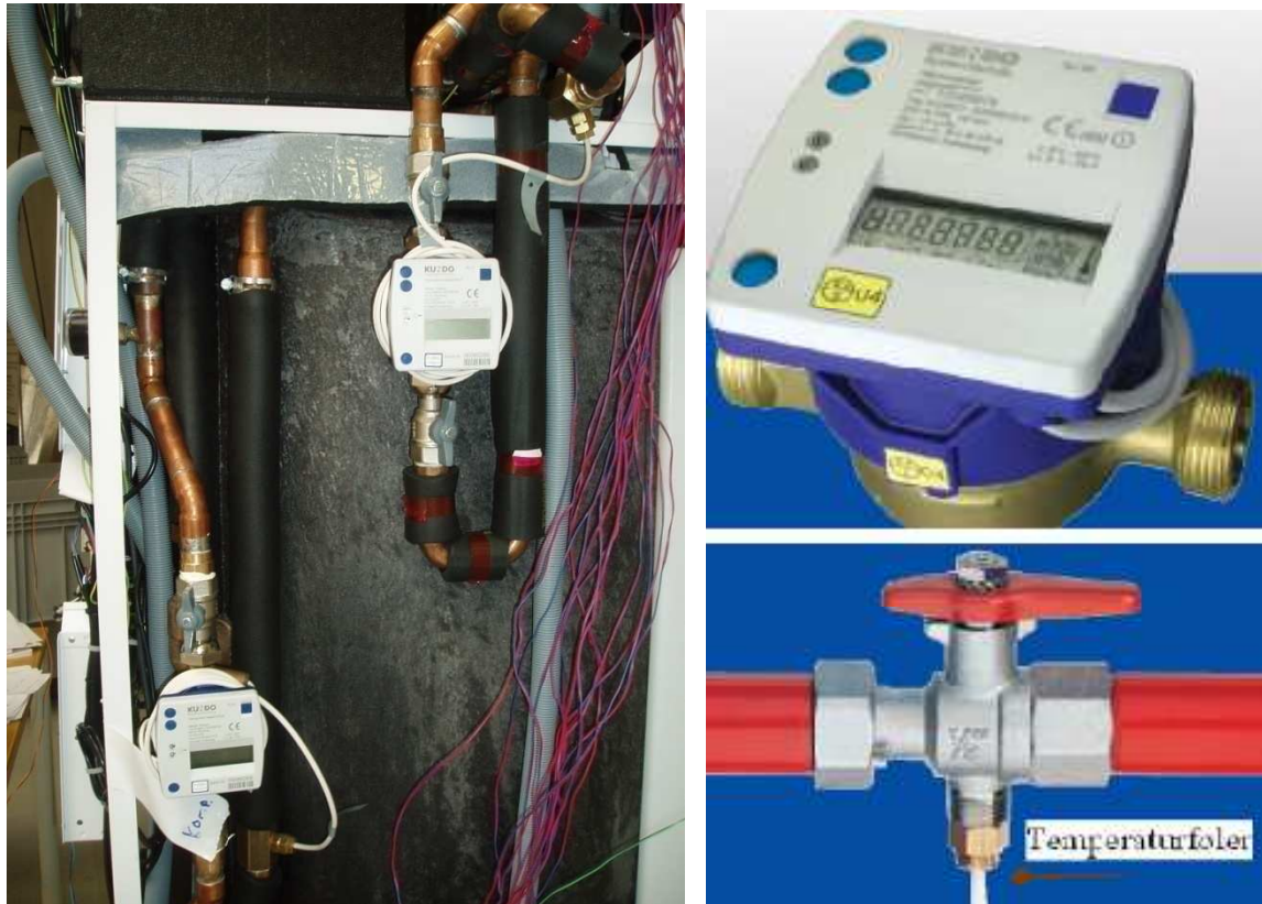
Figur 3.5 På bildene kan man se energimåleren G20 fra Kundo. På bildet til venstre kan man se energimålerne montert på aggregatet. Energimåleren øverst er plassert over kondensatoren, mens den nederste er plassert over varmtvannsberederen. Bildene til høyre viser energimåleren og temperaturføleren, og er hentet fra Zijdemans (2007).
