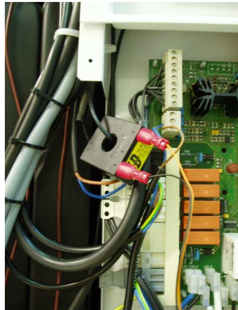
Figur 3.6 Trafo montert på strømforsyningen til kompressoren, for måling av spenning.
