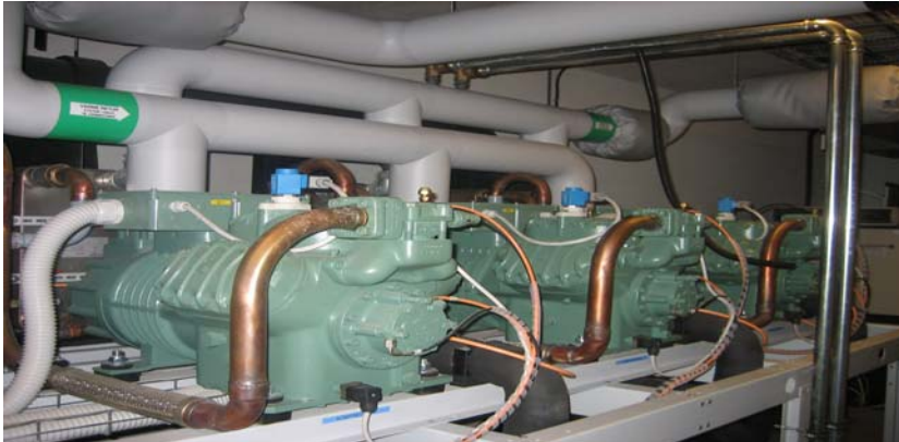
Bilde 6-8 Fotografi av de 3 kompressoraggregatene.
