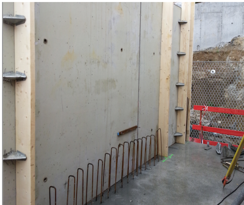
Figur 3.63: Bøylar som stikker opp fra veggstøpen i etasjen under
