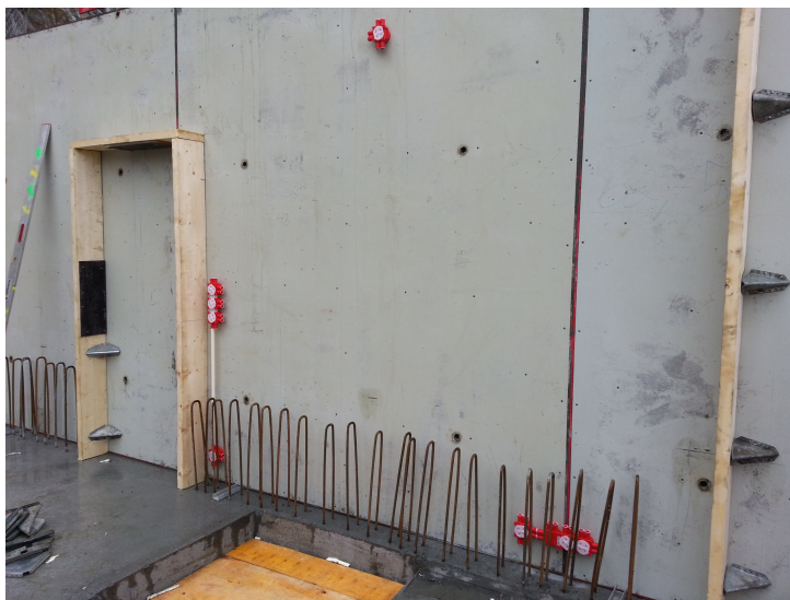
Figur 3.48: Enkling med påspikrede elektrikerbokser
