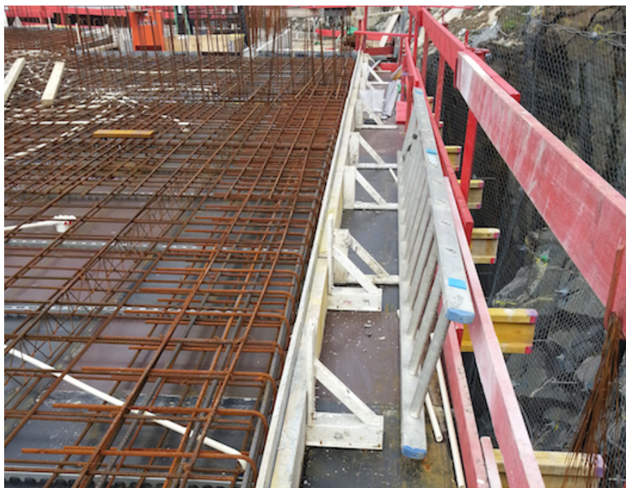
Figur 3.73: Dekkeforskaling hvor det er forskalt lengre ut enn dekket skal støpes
