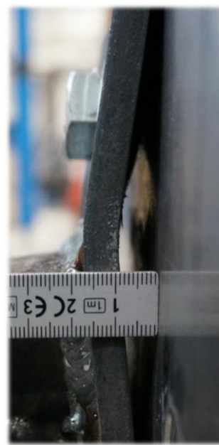
Figur 9.11: Detaljbilde som viser mål for utbøyningen av platen fra Figur 9.10 ved øvre sveis.
