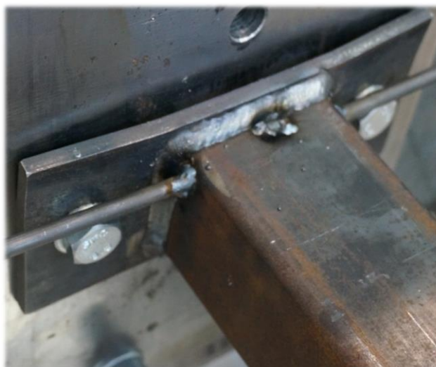
Figur 9.24: Detaljbilde av søylefoten ved påkjenning av 160 kg.
