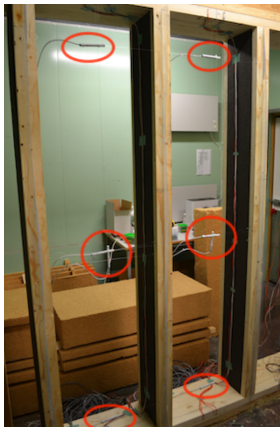
Figur 26: Montering av RF/T-sensorer i elementer med Zell
