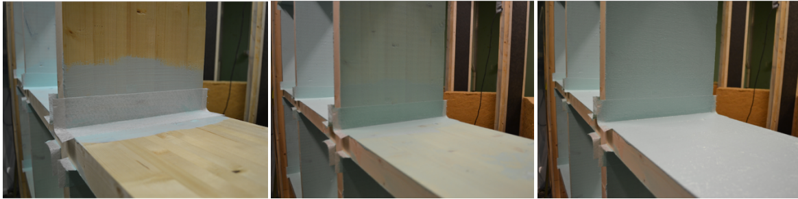
Figur 10: Påføring av Hey'di® smøremembran med sikkerhetsremse i hjørnet, for å hindre fuktpåvirkning fra stenderverket i 1D-forsøket. Første bilde viser sikkerhetsremsen og priming. Andre bilde viser ett strøk membran. Tredje bilde, tre strøk
