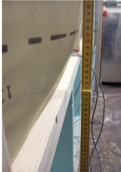
Figur 19: Strekk i dampbremsen etter innblåsing.
