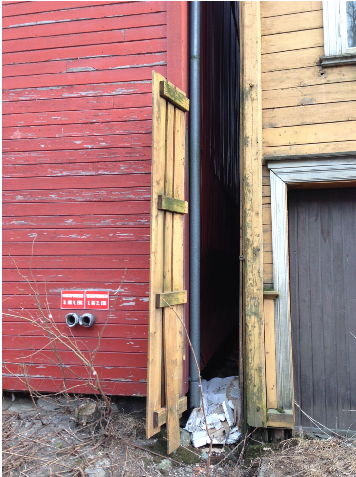
Figur 5.8: Åpen port mot smug med sammenbrettet papp og annet skrot plassert i åpningen. En liten gnist her kan gjøre svært stor skade.
