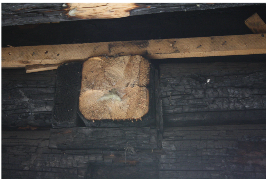
Figur 3.9: Store deler av bjelkens tverrsnitt er fortsatt friskt treverk med lastbærende egenskaper. Bildet er tatt inne i Kjøpennsgata 11 og viser skadene fra en brann her i 1950. Brannen ble slukket før den fikk mulighet til spre seg ut av bryggen og den opprinnelige tømmerkassen bærer fortsatt last i dag, med varierende grad av brannskader.
