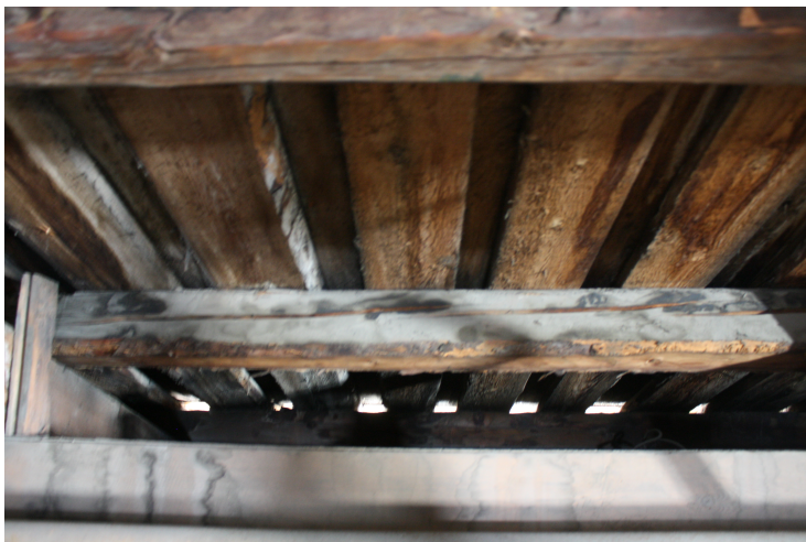
Figur 5.11: Det er ingen tetting i overgangen mellom tak og vegg på loftet i Kjøpmannsgata 27. I veita er påkoblingssprinklere montert i underkant av takfoten.
