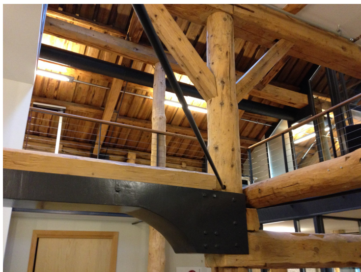
Figur 5.3: Alternativ bæring der trebjelker er kappet for å oppnå tilfredsstillende takhøyde. Bildet er tatt i Kjøpmannsgata 37, der de øverste etasjene er tatt i bruk til kontorer.
