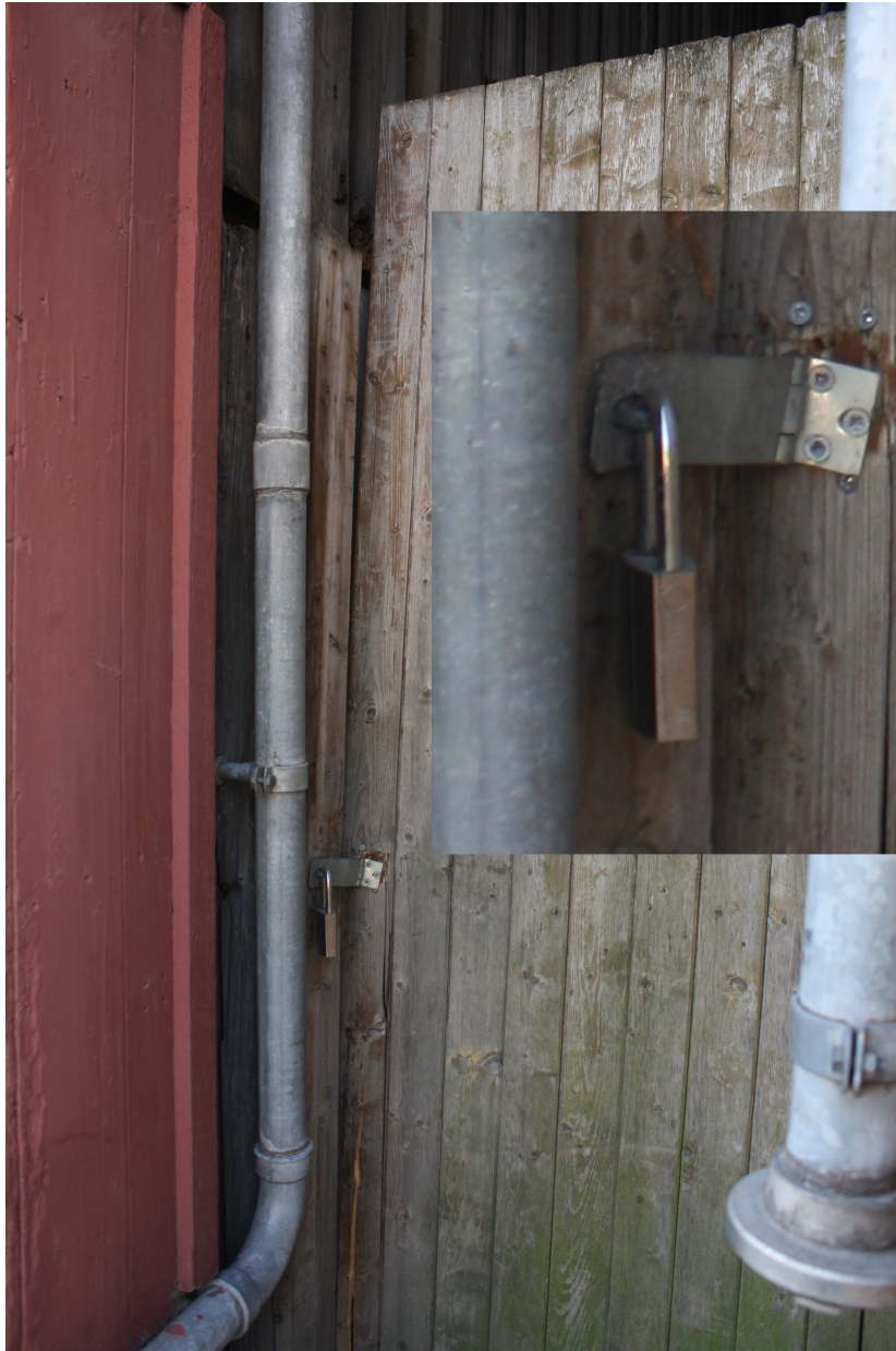
Figur A.3: Sikringen gir inntrykk av å være svært provisorisk. Det er nok enklere å skru av beslaget enn å dirke opp låsen. 102
