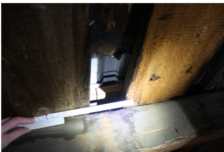
Figur 5.12: Skader i konstruksjonen svekker brannmotstanden. Her fra taket i nr. 27.
