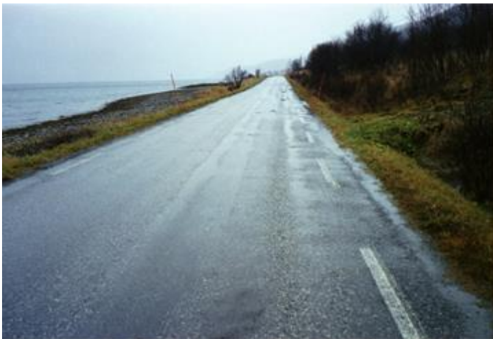
Figur 16: Kantskader i ytre hjulspor (Granlund, 2013)
