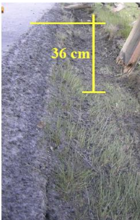
Figur 8: Asfaltkant som medførte at et vogntog krasjet (Statens havarikommisjon, 2011)
