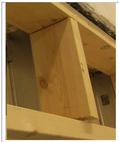
Figur 131: Dårlig tilpassing og manglende innfesting av stender over vinduskarm.
