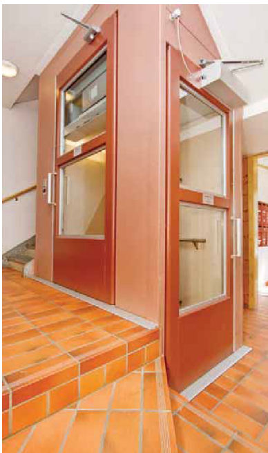
Figur 6: Eksempel på smalheis på Hamar. Heisen i Langenga borettslag sikrer trinnfrihet. Heisen er plassert i trappeøyet i en treløpstrapp. [65]
