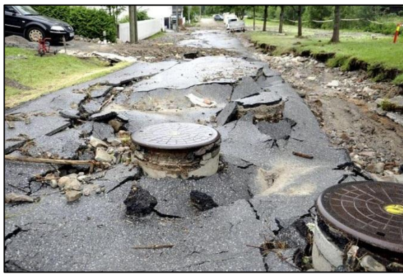
Figur 8-11: Skader på veg på grunn av flom 9
