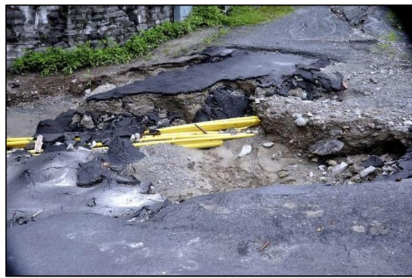
Figur 8-10: Utvasking av bærelag og forsterkningslag som følge av vann i vegbanen 9
