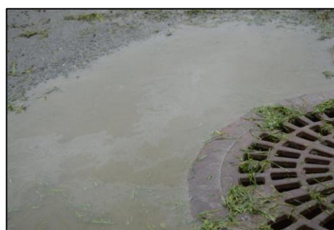
Bilde 5-1: Forurenset overvann i oppstuvning ved sluk.
