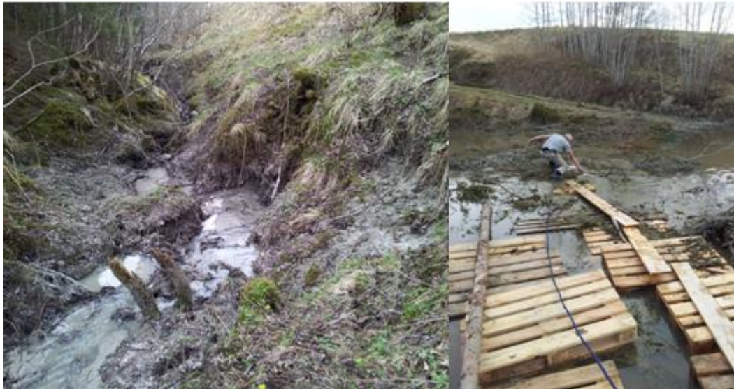
Figur 6-4: Venstre: Erosjon langs bekkeløpet som renner sørover lokalisert like vest for skredgrova. Høyre: Oppløst overgang ved oppdemmet bekkeløp.
