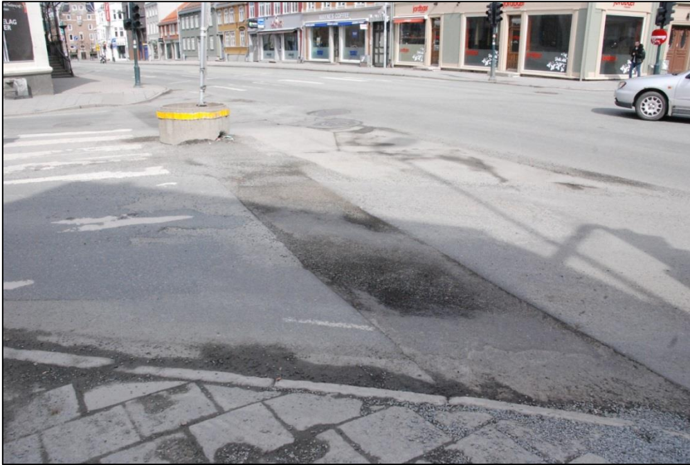
Figur 71: Hull i asfalt i Erling Skakkes gate
