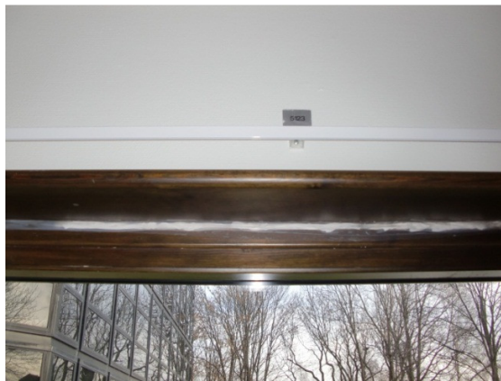
Figur 46 Forsøk på tetting av glippe mellom ramme og karm
