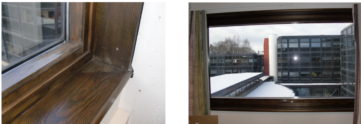
Figur 48 Fuktskade i hjørne av vindauge
