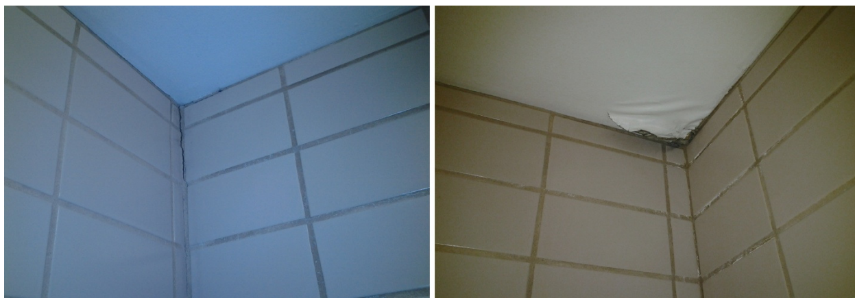
Figur 42: Sprekk og fuktskade i rom 229
