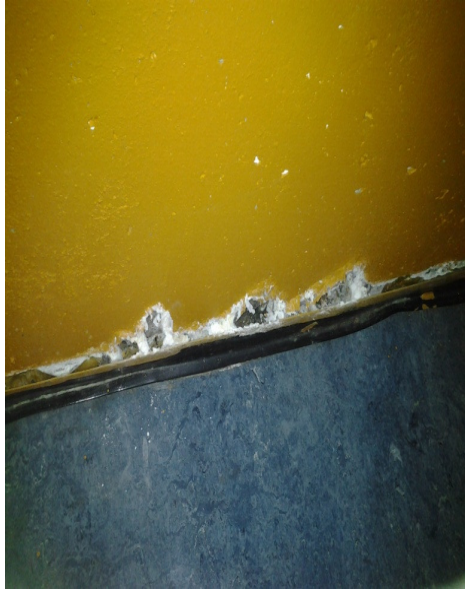
Figur 38: Skader på vegg i treningsrom i kjelleren
