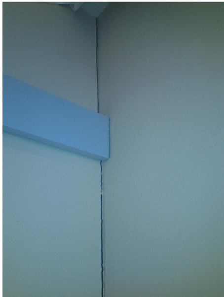
Figur 41: Sprekk langs veggen i rom 265
