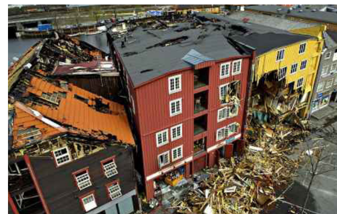
Konstruksjonen som stod igjen på tomten Fjordgata 80 etter rivning av skadede bygningselementer etter brannen. 53
