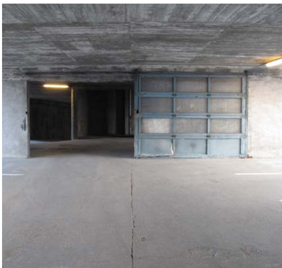
Store skyveporter ved innkjørselene til parkeringsdekkene.
