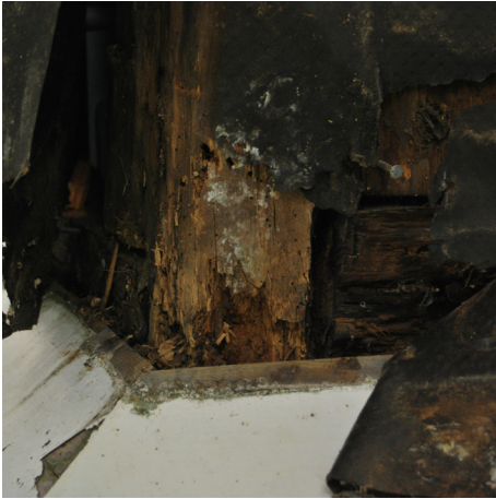
Røteskade i klokketårnet på Undredal stavkyrkje grunna takpapp som har hindra utlufting.
