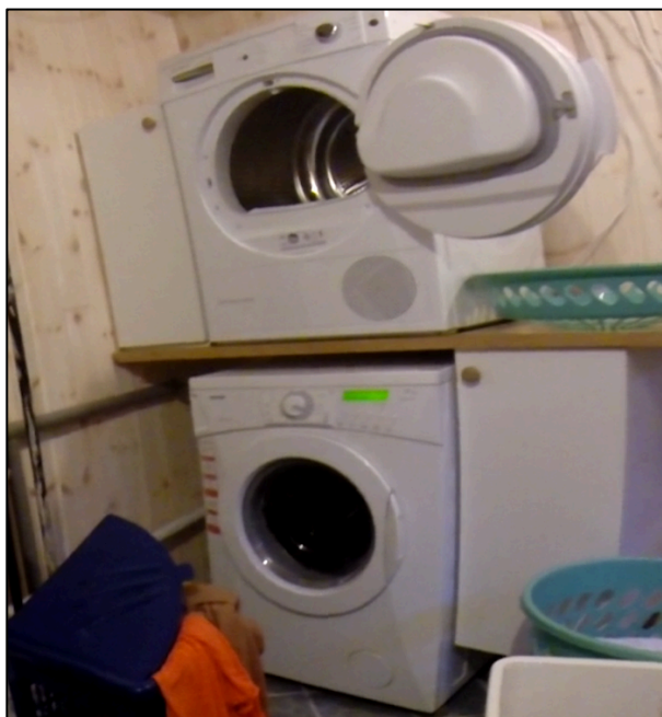
Figur 5: Vaskemaskin og tørketrommel – to apparater det ikke er lov å starte samtidig.
