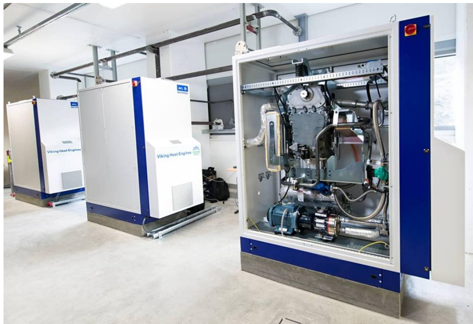
Bilde fra Returkraft i Kristiansand, hvor Viking Heat Engine er installert med tre maskiner 2013. Gjengitt med tillatelse fra Harald Nes Rislå- Viking Development Group
