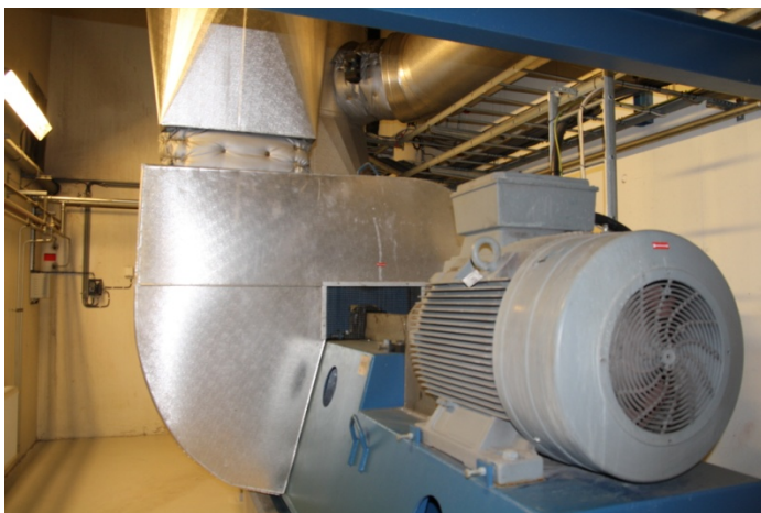
Bilde 16. Røykgassvifte ved biobrenselanlegg
