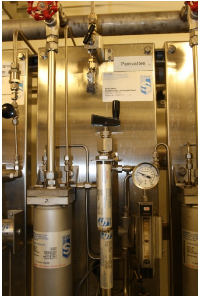
Bilde 28. Prøvestasjonen for Kjelvann- Det er en prøvestasjon for alle avtappings steder – Overheter, før og etter turbin og også for vann for fjernvarmenettet.
