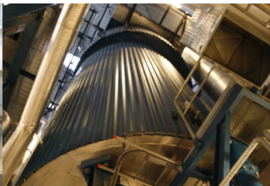
Bilde 15. Rensefilteret sett nedenifra
