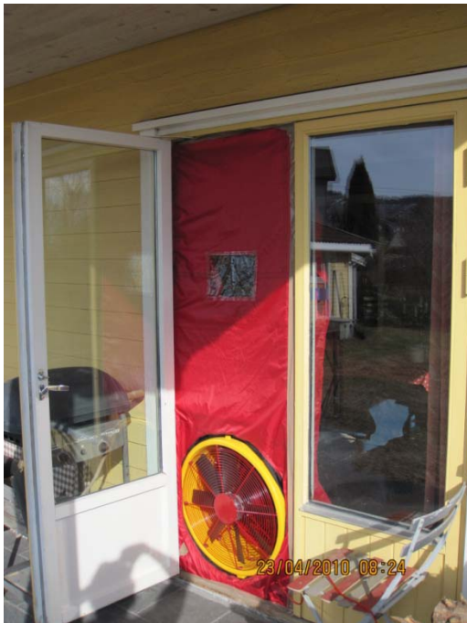
Figur 38 – Trykktestingsutstyret montert i dør
