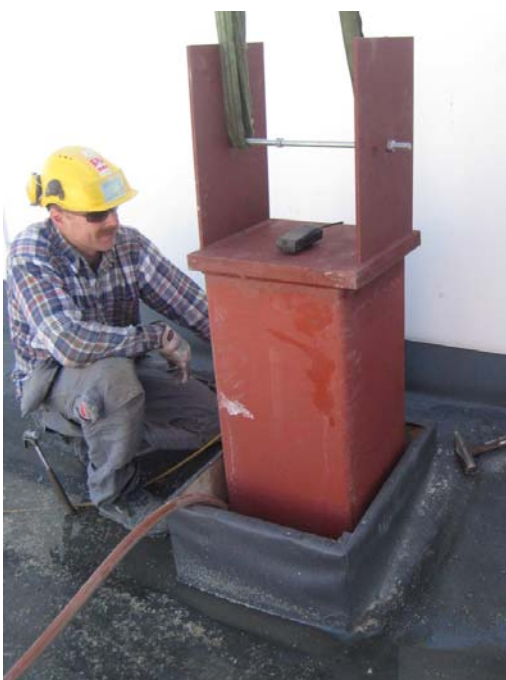
Figur A.8. Gaffellagring for NIB 1800 montert ved CC Mart'n, Gjøvik. Foto: Audun Hovrud
