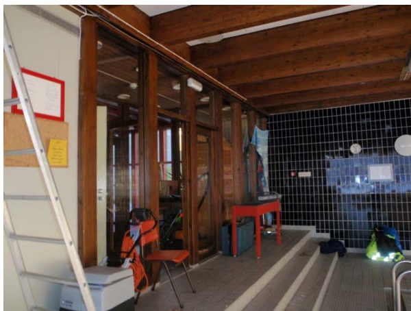
Bilde 5: Sluse mellom vestibyle og svømmehall. Nivåforskjell i gulvet på tre trinn gjør det vanskelig med tilrettelegging for HC-brukere.
