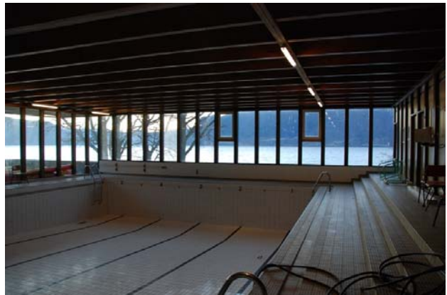
Bilde 4: Innvendig. Badet har vært stengt i 3 år.
