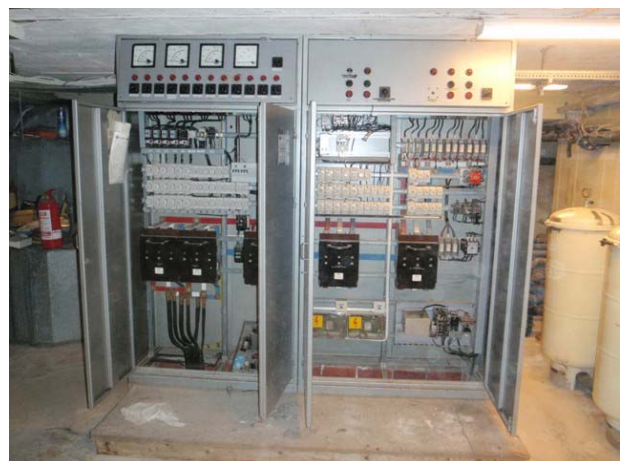
Bilde 18: Alt teknisk anlegg må skiftes, inkludert el-tavler, som er gamle.
