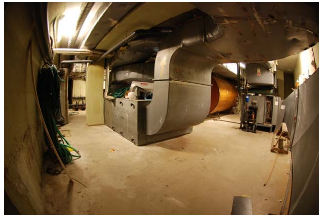
Bilde 10: Teknisk rom i kjeller. To aggregater, hvorav bare den ene er i bruk.
