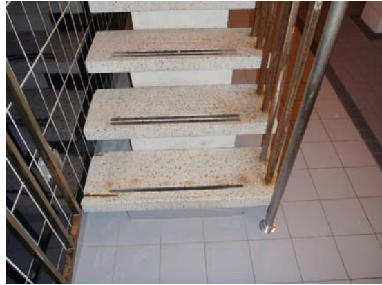
Bilde 14: Dusjer er også renoverte. Trappen er opprinnelig, og på sikt må den skiftes pga armeringskorrosjon. Korrosjon på stålgitter.
