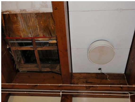
Bilde 9: Tak er dårlig og ble åpnet og inspisert. Det har vært store problemer med kondens.
