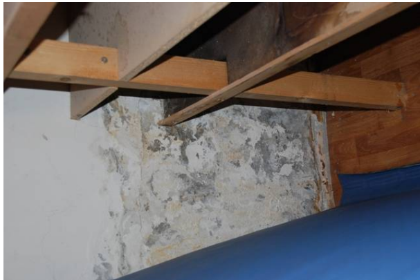
Bilde 15: Tørrside basseng. Fuktutslag på nedre del av vegg.
