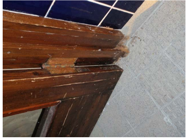
Bilde 8: Slitte dører og korrosjon på dørbeslag.
