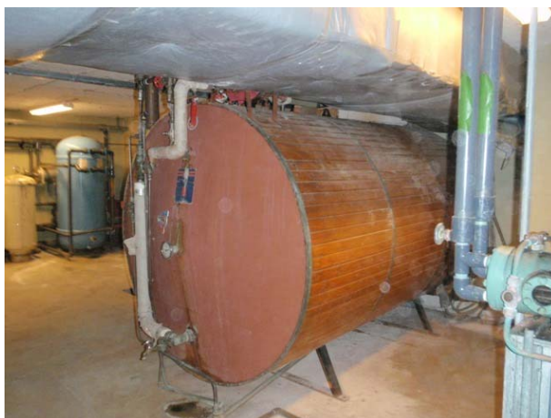
Bilde 17: Alt teknisk anlegg må skiftes. Her ses varmtvannsbereder.
