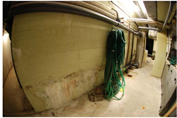
Bilde 16: Tørrside basseng. Lekkasje i overgang bassengvegg og bassengbunn.
