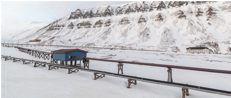
Alle rør går i rørgater over bakken. Ingenting graves ned grunnet permafrost. (Foto fra NRK).
