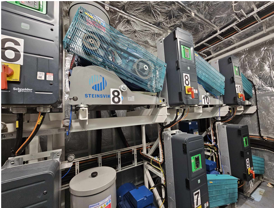
Figur 4.4: Blåsere i blåserom ved Lønngrunnen. Bildet ble tatt av gruppen under befaring
