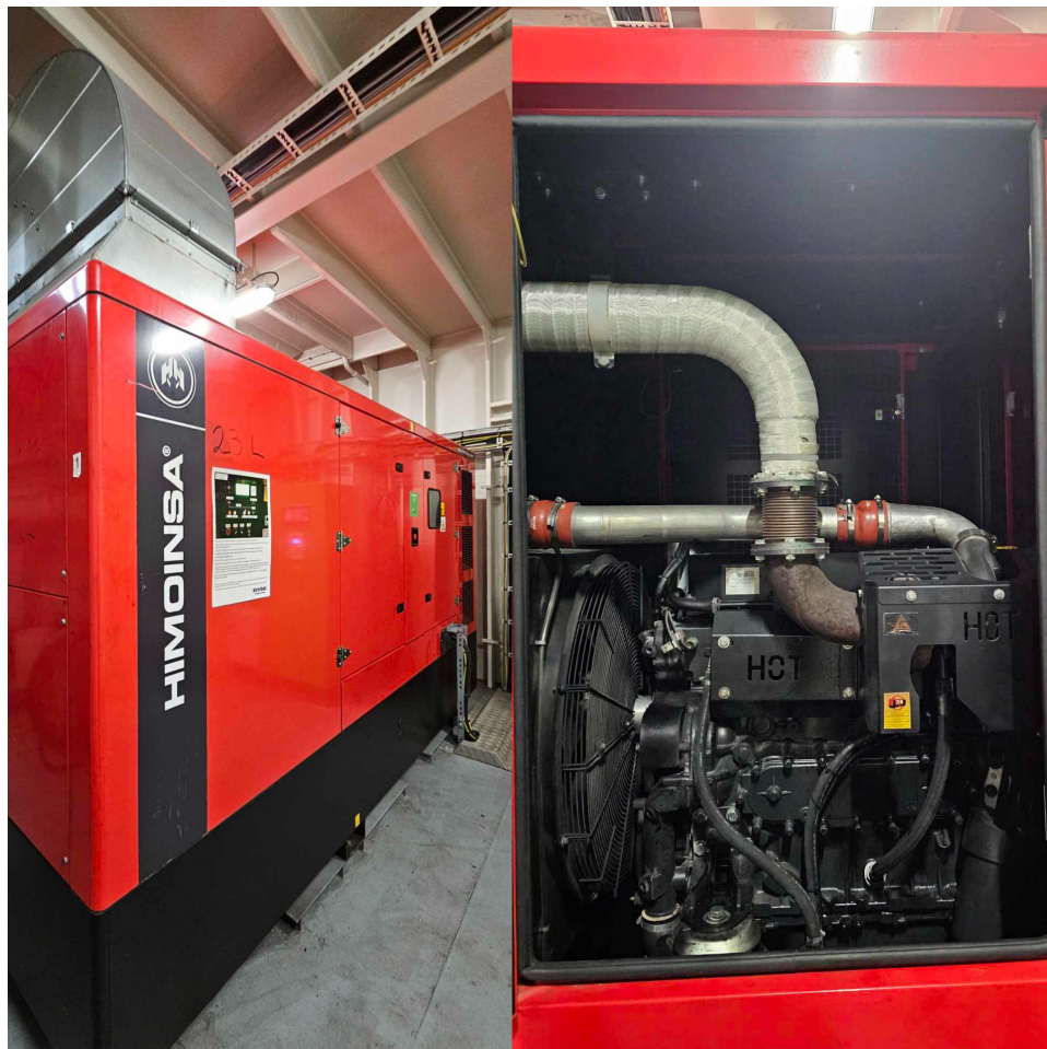
Figur 4.2: Én av to generatorskap og generatorer ved Lønngrunnen. Generatorskap vises t.v. og generator t.h. Bildene ble tatt av gruppen under beforing
