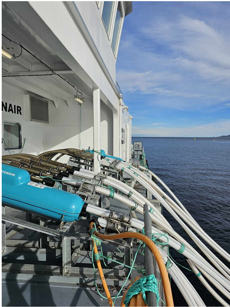
Figur 4.6: Fordelingsventiler ved Lønngrunnen. Bildet ble tatt av gruppen under befaring
