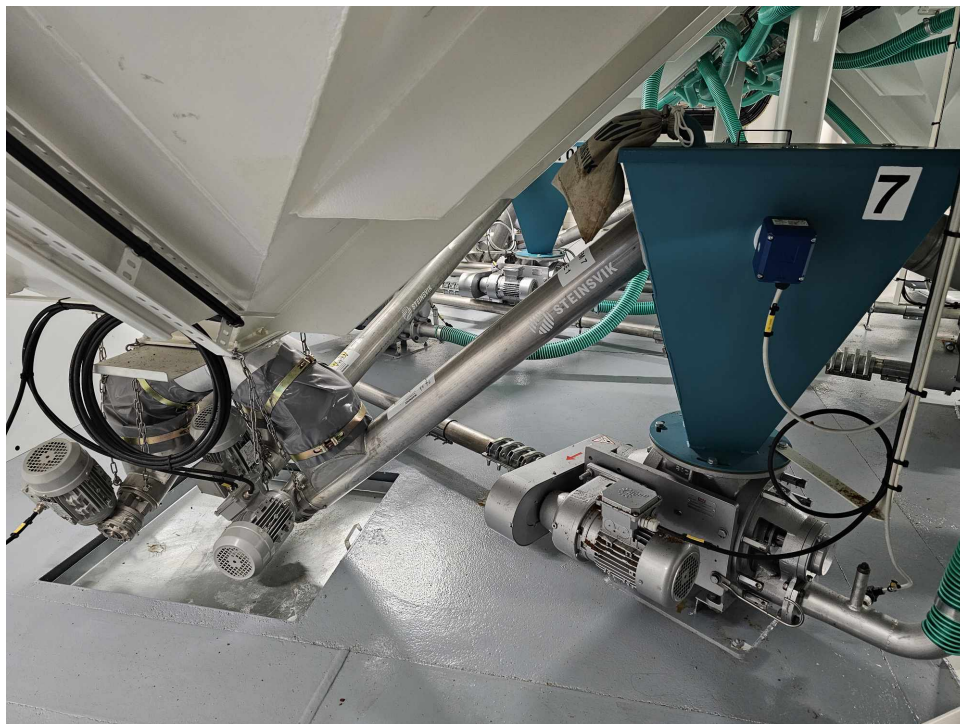
Figur 4.5: Fôrskruer og sluseventil ved Lønngrunnen. Bildet ble tatt av gruppen under befaring
