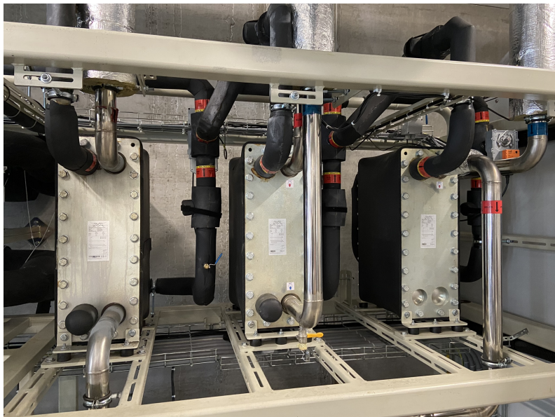
Figur 13: Bilder av gasskjølerne i CO 2 -varmepumpa.
