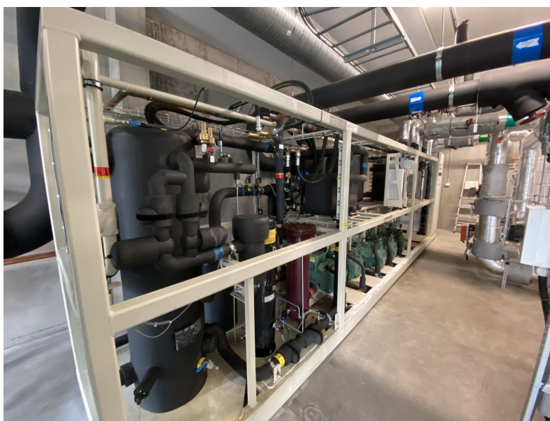
Figur 12: Bilde av varmepumperigg i Billingstad energisentral.
