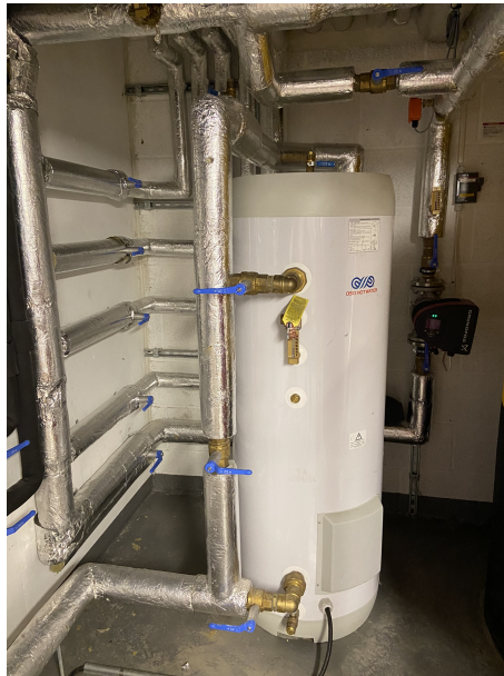
Figur 19: Bilde av varmtvannsbereider som dekker varmebehovet for varmtvannssirkulasjon i kundesentralene.
