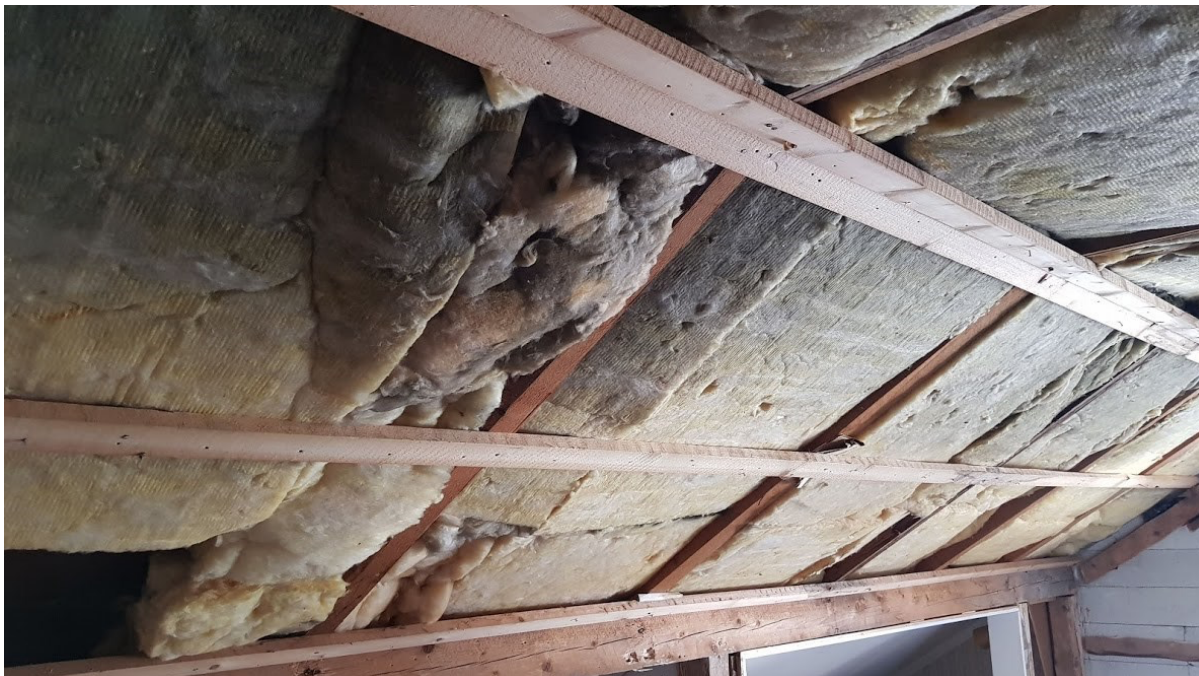
Figur 9: Fuktskadet isolasjon (Byggebolig, 2021)
