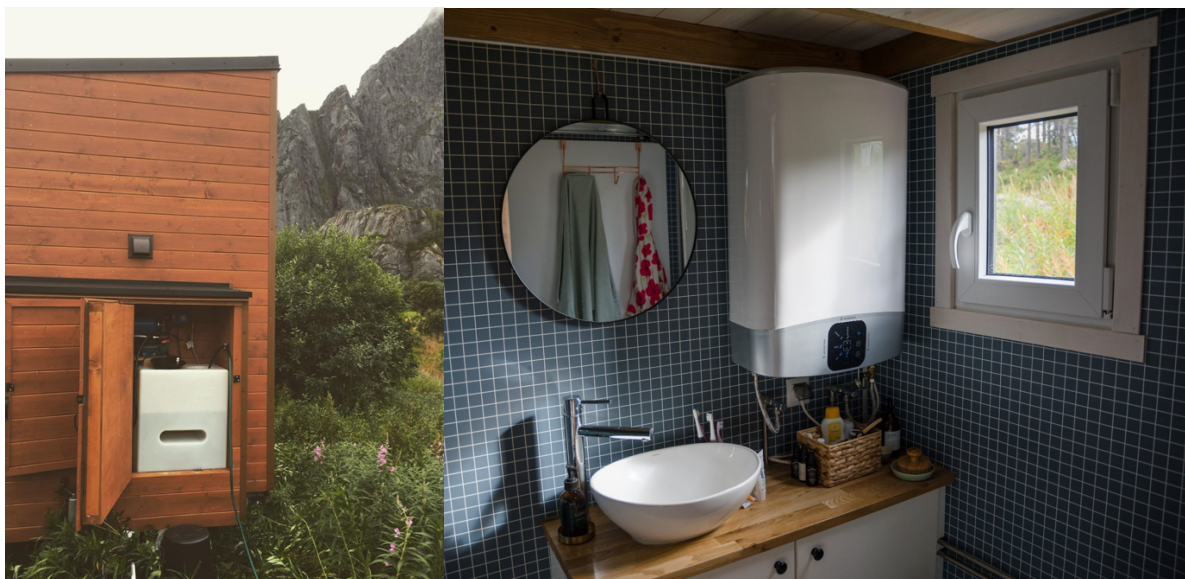
Figur 5. Vanntank på utsiden av mikrohuset. Foto: Freya. Figur 6. Badet i mikrohuset. Foto: Jon Olav Larsen.
