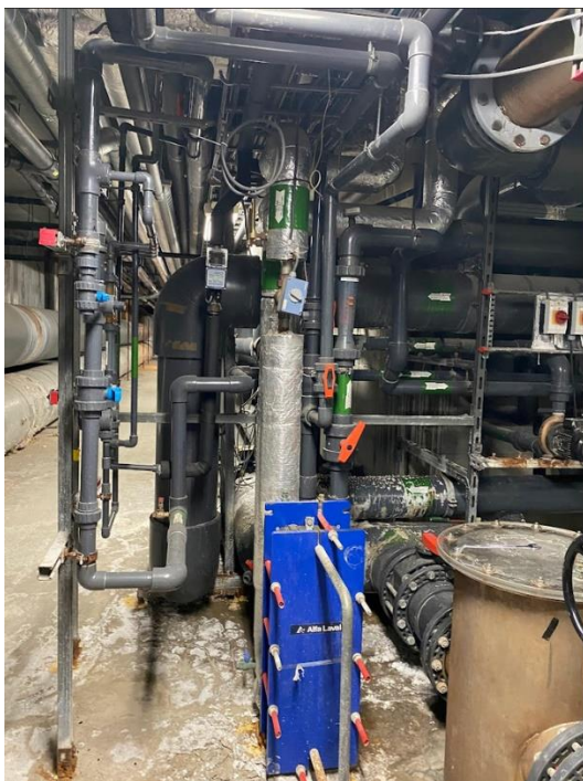
Fig. 17: Teknisk utstyr på siden av bassenkonstruksjonen i Pirbadet, fra befaring 4. mai
