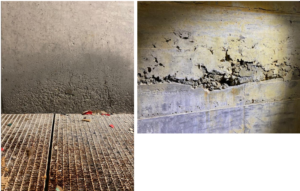
Fig. 8: Steinreir og støpesår i den gamle bassengkonstruksjonen i Pirbadet. Fra befaring 19. januar.
