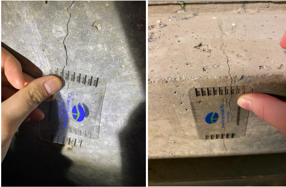
Fig. 16: Måling av riss i Pirbadet, fra befaring 4. mai.
