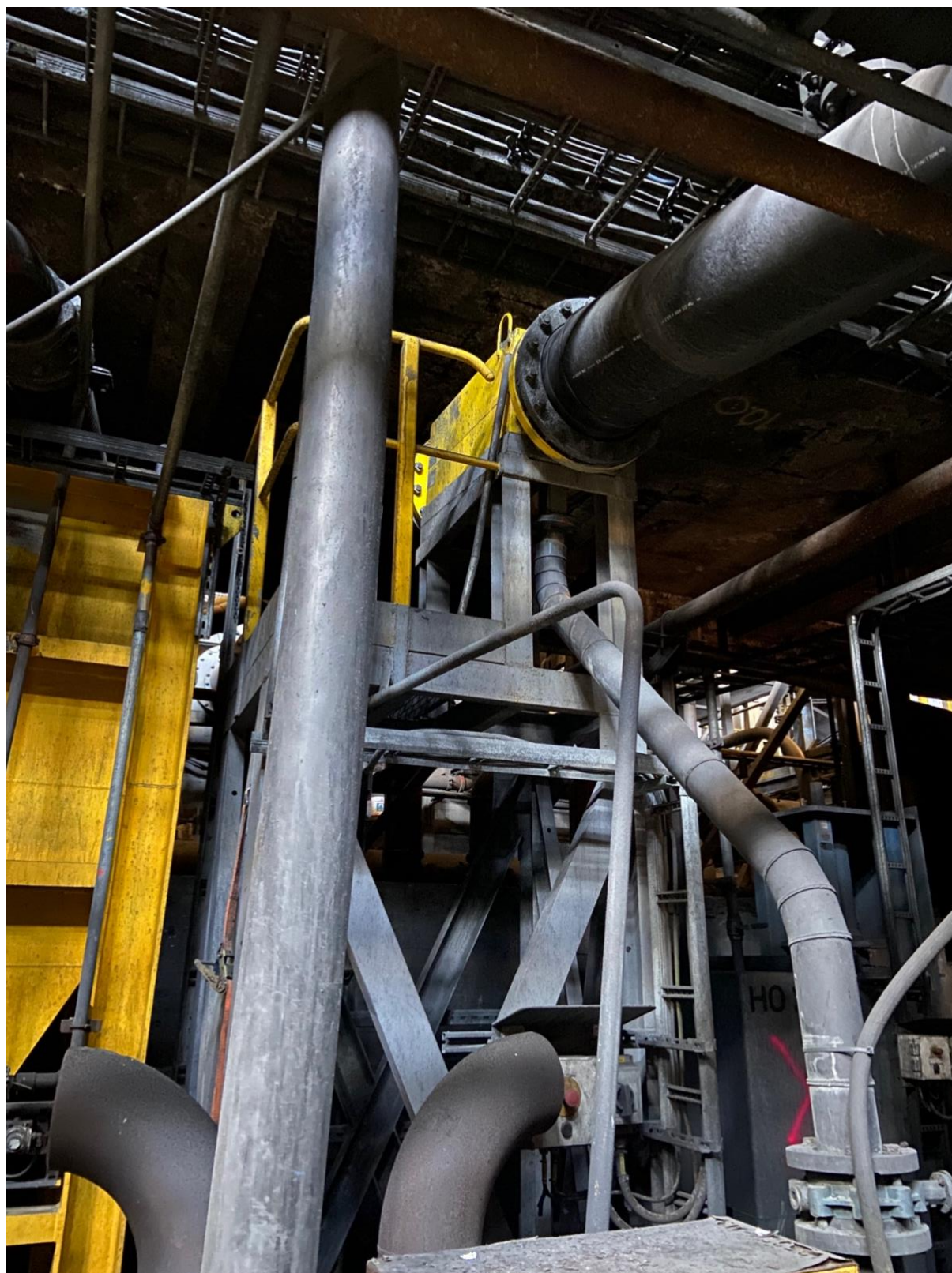
Figur 7 viser en diverter (gul boks) som sitter montert på røret, denne sender strømmen ned det svarte tynne røret til en prøvetagningsstasjon.
