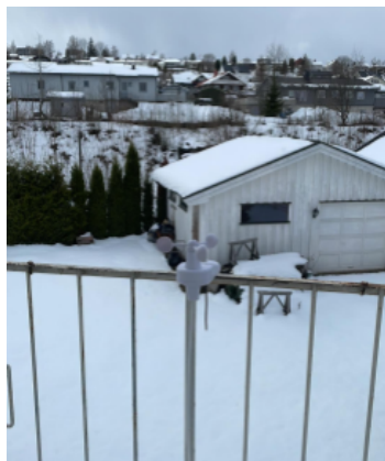
[8]: Vindsensoren oppmontert for kalibrering og testing av funksjonalitet. Foto: Jørgen Johannessen
