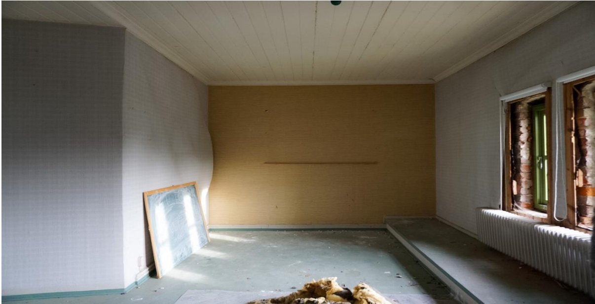
Bilde 9: Rom på loftet som tidligere har vært i bruk. I dag er det et tomt rom med gammel isolasjon fra vinduene på gulvet og gammel tapet på veggene. Fotograf: Sara Elise S. Augland
