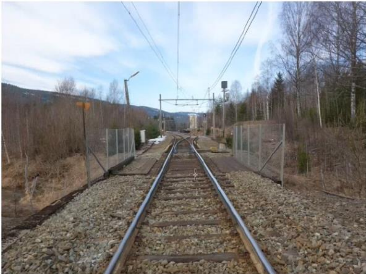
Figur 23 Viser fastmontert spor på bjelke, både vertikal- og horisontalretning. Uheldig metode mht. solslyng (når skinnene ikke kan bevege seg, oppstår store strekk- og trykk i skinnene). (Bane NOR, 2022a)
