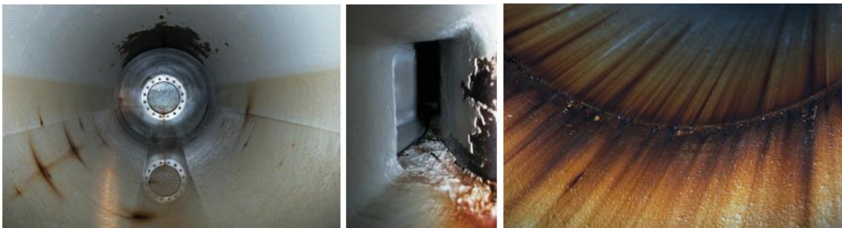
Figur 14 - Korrosjonsskader turbin T3
