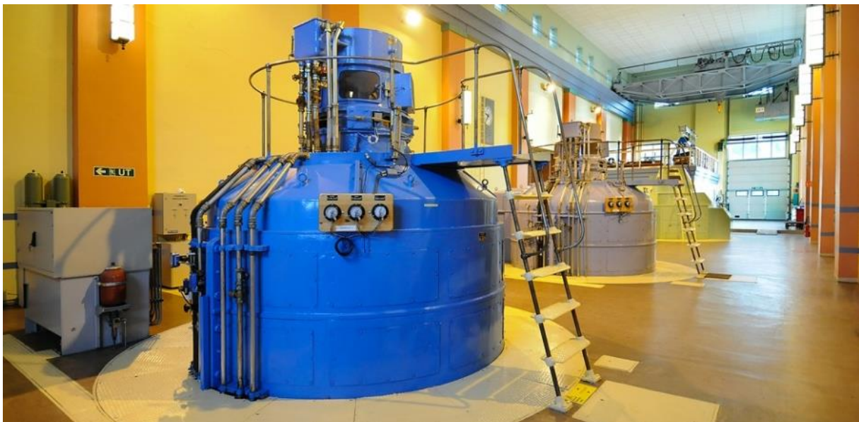
Figur 13 - Maskinsal Nygård kraftverk
