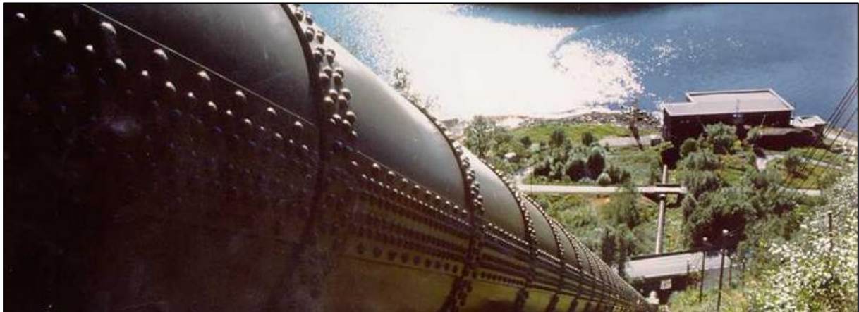
Figur 3 - Nygård Kraftverk sett fra rørgate
