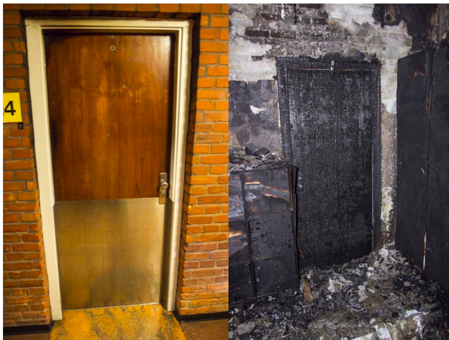
Figur 2.3: Forsiden og baksiden av en branndør etter en brann. Foto: Notodden brann- og feiervesen.
