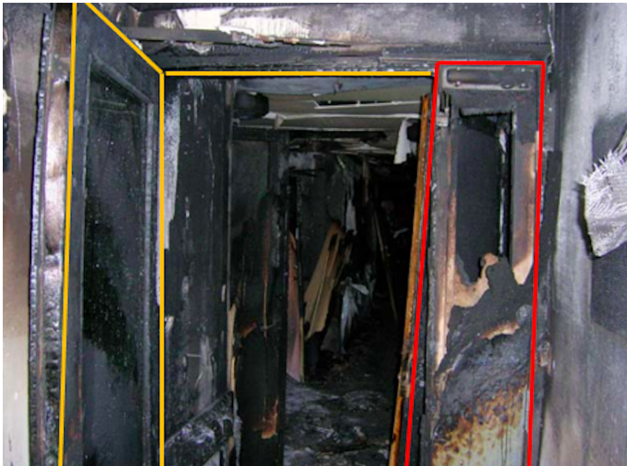
Figur 5.1: Aktiv fløy med døråpning markert med gule linjer. Røde linjer viser skåtefløyen. Brannspredning forbi brannklassifisert dør som ble holdt åpen av trekile (Direktoratet for samfunnssikkerhet og beredskap, 2007).
