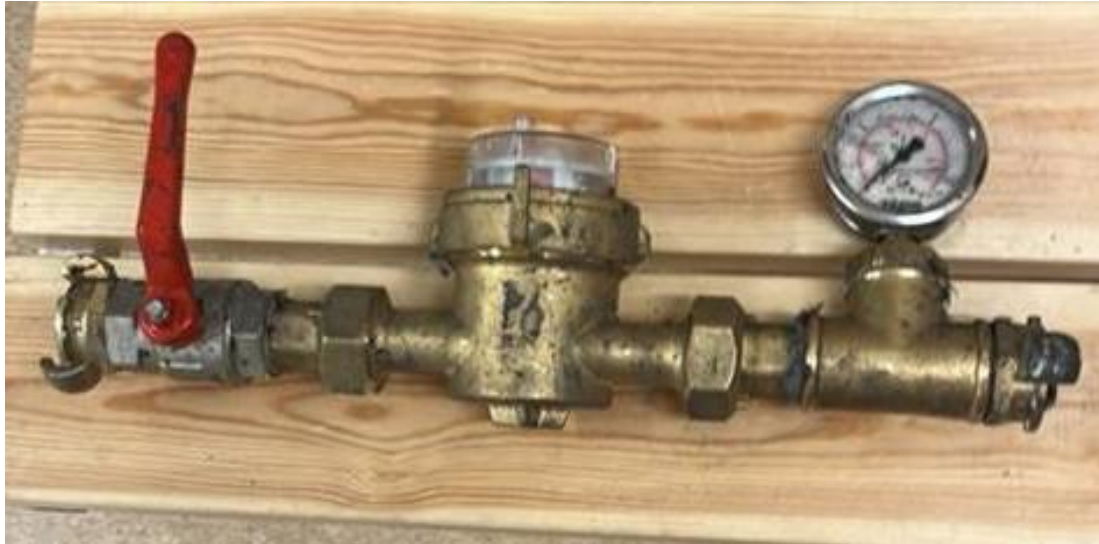
Figur 3.8: Kobling med flowmeter og manometer benyttet til vanntapsmålinger. Foto: Eivind Stein
