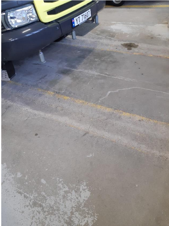
Figur 12. Dette bildet viser gulvet i driftsbygget på Svolvær lufthavn. Dette gulvet trenger en oppgradering på grunn av at betongen inneholder ulovlige stoffer.
