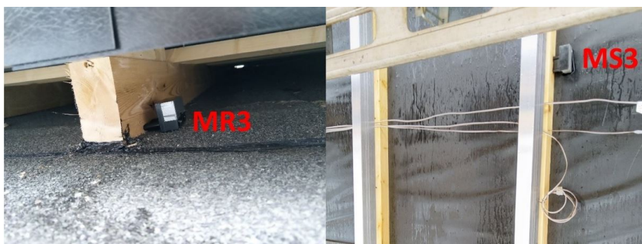
Figur 3.16: Bilde av hvordan sensorene er plassert i luftespalter i fasadene og i taket i ZEB-laboratoriet (Rønningen, 2020).
