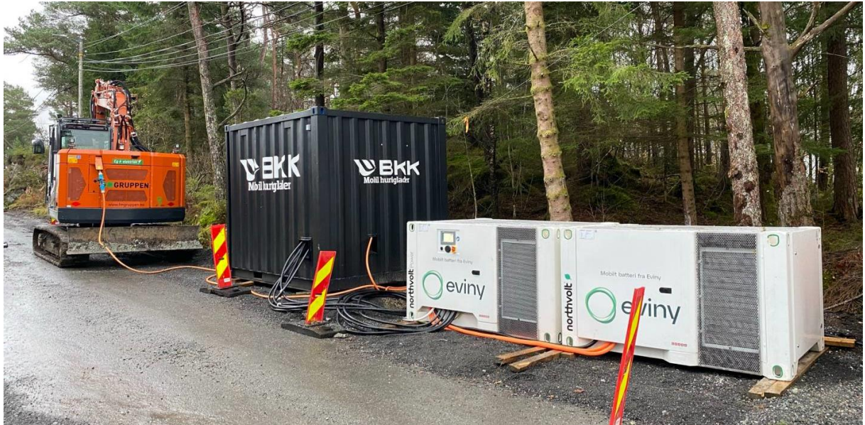
Figur 2: Eviny's batteriløsning i bruk på byggeplass (Eviny, 2022).
