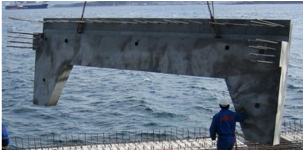
Illustrasjon: Fendervegg med litt annen utforming, viser prinsipp for armering. Hentet fra Elementpartner AS.
