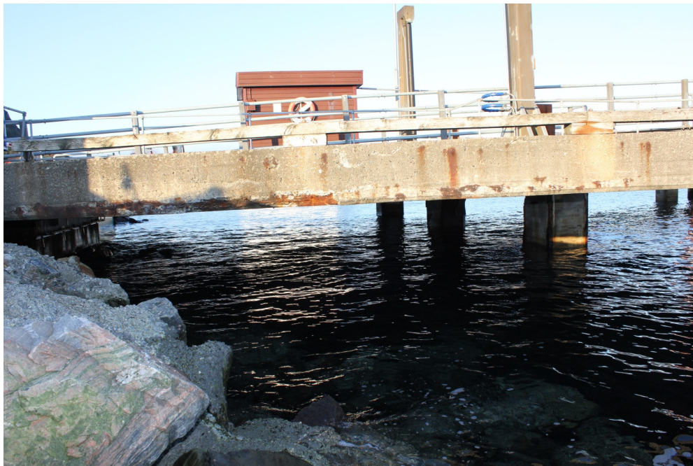
Bilde 4: Synlig armering på fergekai
