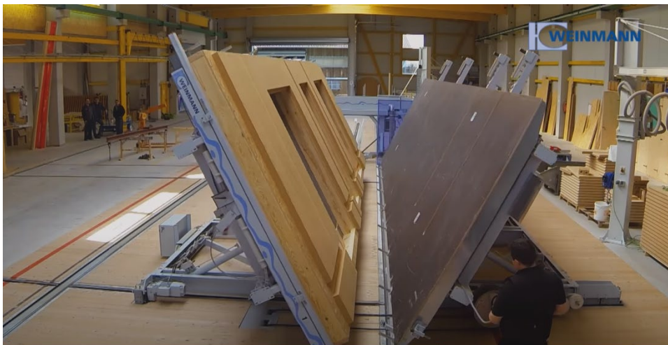
Figur 36 Vending av hele elementer for å kunne legge inn isolasjon og sette på himling.
