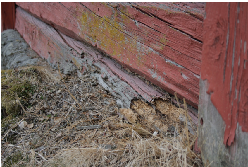
Figur 10: Eksempel på synlig råteskade i yttervegg fra bygg 2. Foto: Sindre Kåseth.
