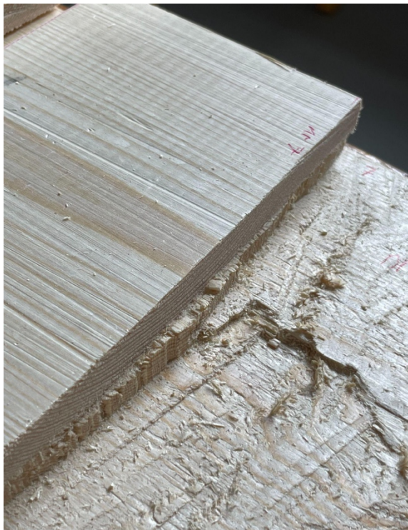
BILDE 108 – EKSEMPEL PÅ NÅR DET BLIR LIGGENDE IGJEN EN FORHØYNING I SIDENE PÅ TAPPHULLET
