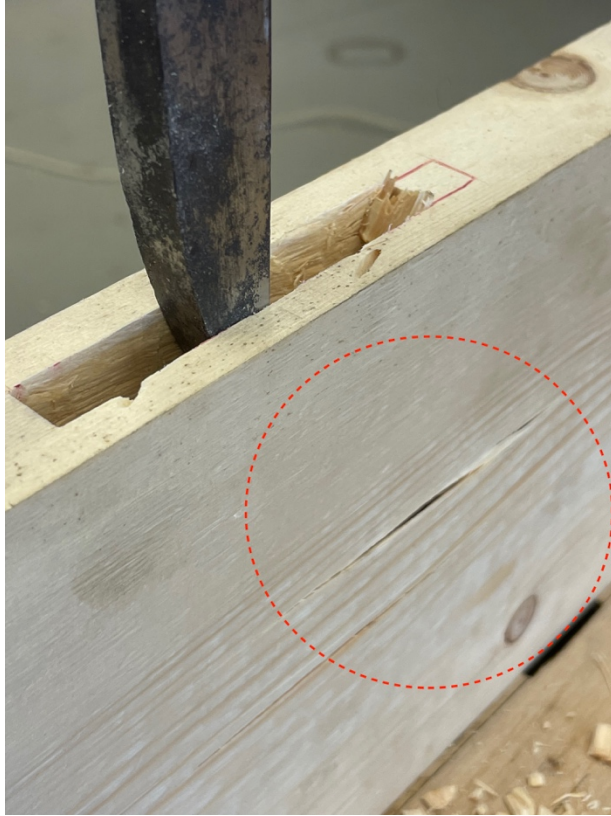
BILDE 110 - EKSEMPEL PÅ SKADE I TAPPHULLVEGGEN
