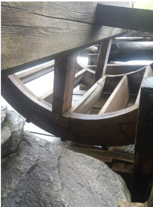
Figur 26 Nærbilde av skovler og bunn av renna under vannhjulet på Aursfjordsaga. En setning i opplagringen til hjulet gjør at hjulet tar bort vannrenna. Foto: Morten Pedersen
