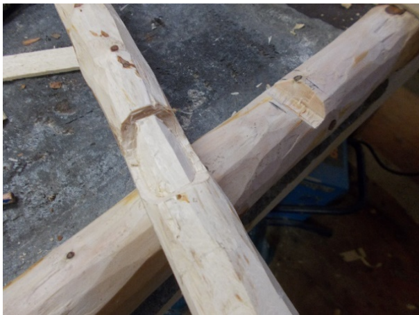
Figur 43 Felling på svill under vannrenne. Foto: Morten Pedersen
