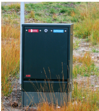
Figur 14: Kabelskap, hentet fra (Griug.no, 2022)
