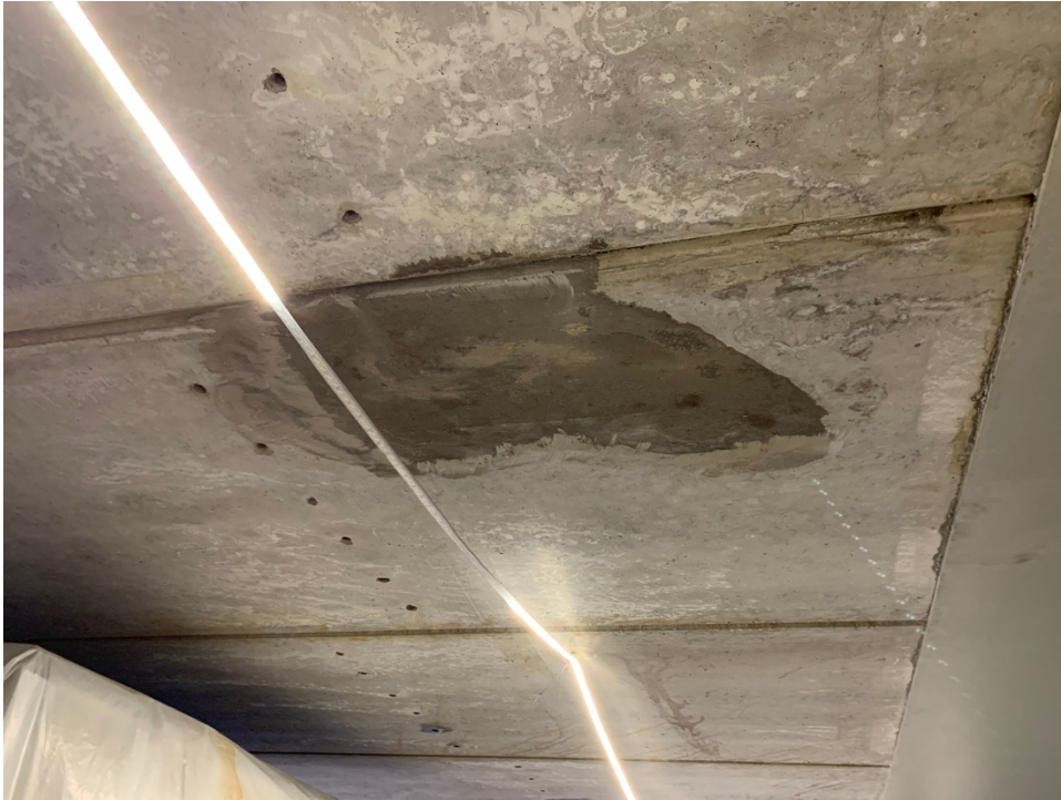
Figur 2: Frostsprengning i hulldekke
