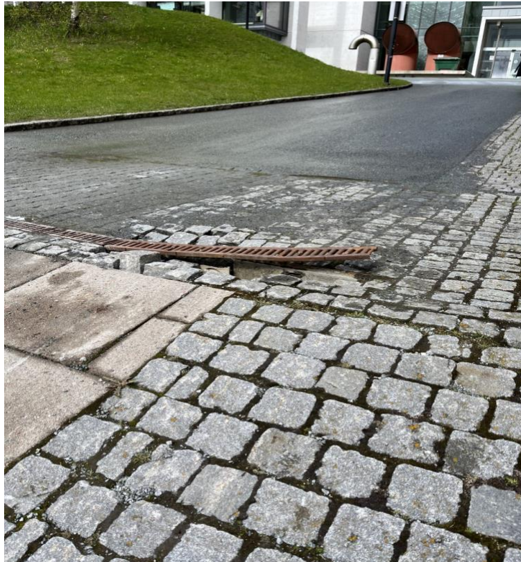
Foto 1. Skade på uteområde som følge av brøyting. (Aas, B. Personlig kommunikasjon 2022)
